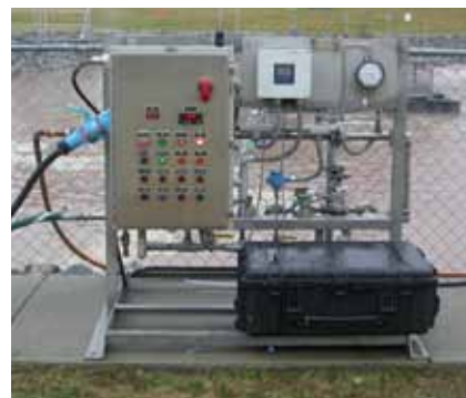
Skid de régulation d'injection d'oxygène
