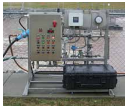
Skid de régulation d'injection d'oxygène
