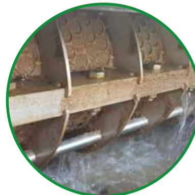
Traitement des boues
