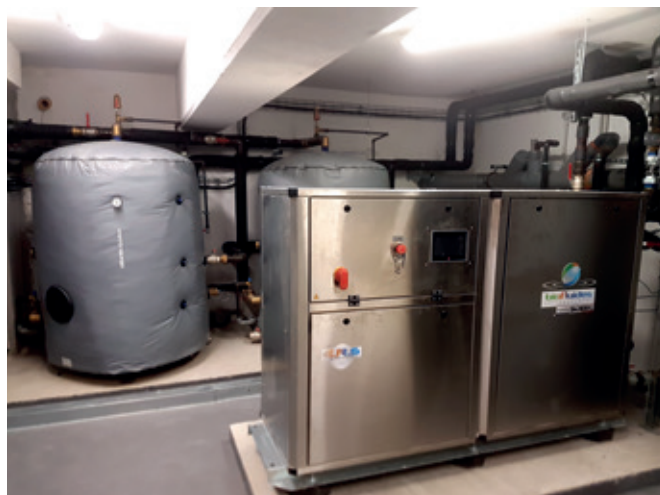
La seule récupération des calories des eaux grises par l’unité ERS couvre 100 % des besoins pour le préchauffage à 55 °C de la production de l’eau chaude sanitaire des 147 logements de la résidence étudiante André Dunoyer de Segonzac à Guyancourt (78).
