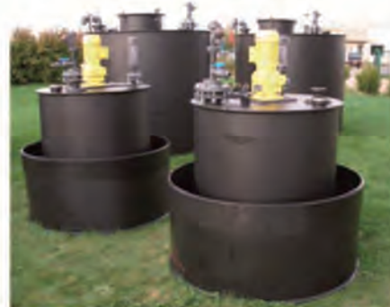
Désinfection des eaux usées par régulation de pH et chlore, par batch avec agitation
