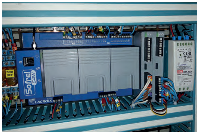
S4W est d'ores et déjà présent chez les premiers clients qui le découvrent et le testent. Ici, vue d'une installation dans le sud de la France.
