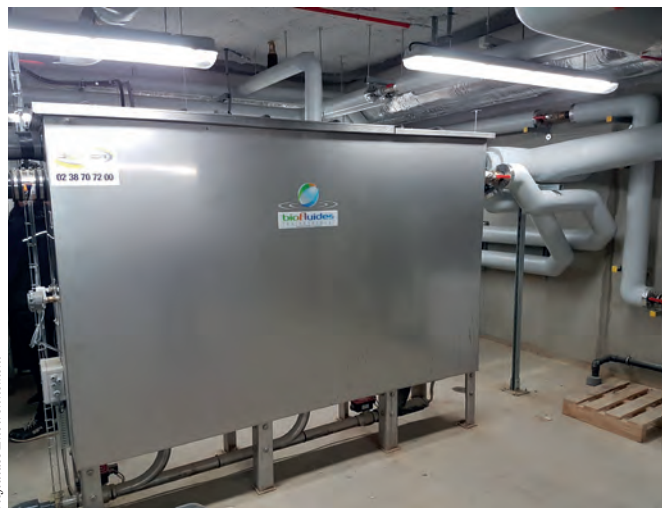
L'unité ERS couplée aux panneaux solaires thermiques installés sur le toit du lycée, couvre 100 % des besoins en eaux chaudes sanitaires des 110 chambres des internes, de l'infirmerie et des points d'eau du lycée.
