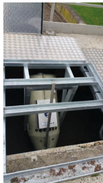
Vue d'un aérateur à vis hélicoïdale installé.
