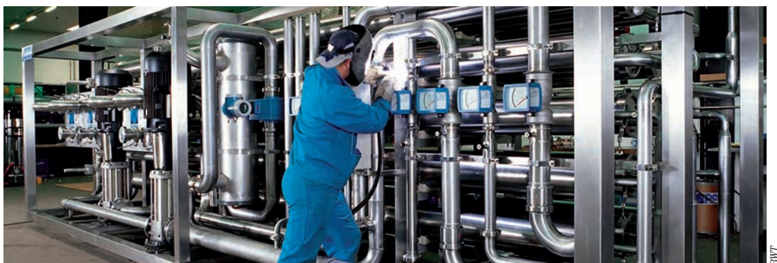
Installation de biosmose inverse de conception alimentaire, débit 40 m 3 /h. Client Agroalimentaire, application : embouteillage d'eau plate.
