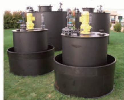
Désinfection des eaux usées par régulation de pH et chlore, par batch avec agitation
