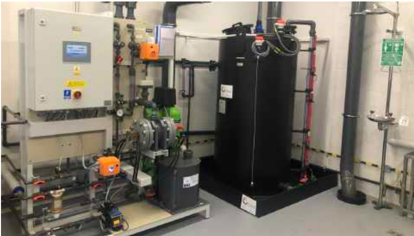
Installation d'un système OSEC® B pour une production d'hypochlorite de 500 g/h.
