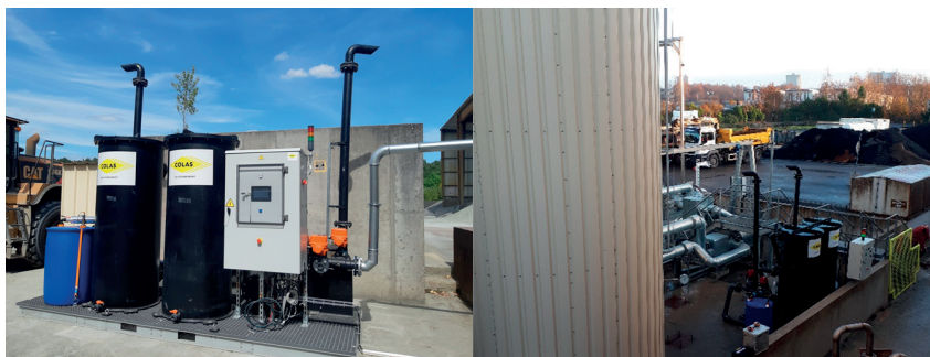
Figure 1 : Exemple de SKID de traitement.
