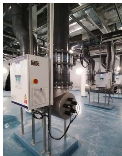
UV Germi a équipé le centre aquatique olympique de Saint-Denis avec des systèmes de déchloramination par UV UVDechlo.
