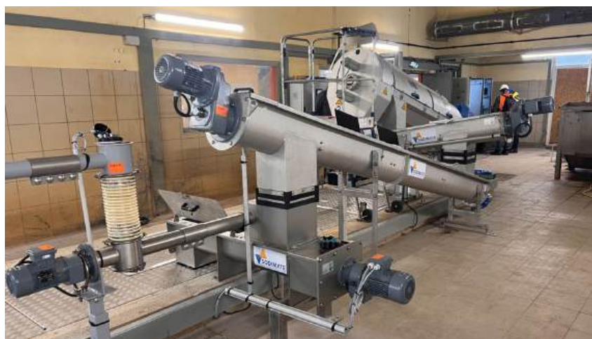
Dans cette application, Sodimate a mis en place un ensemble constitué par un convoyeur de boues et d'un malaxeur.
