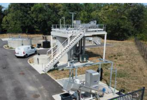
PRÉTRAITEMENT dégrilleur grossier/fin, vis compacteuse
