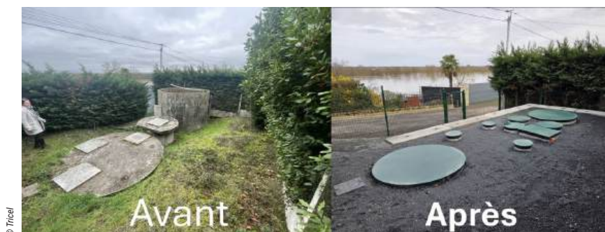
Tricel a mis en œuvre la Tricel Combi dans ce projet de rétrofit d'un lotissement de 140 équivalents-habitants et équipé d'une station d'épuration monocuve.
