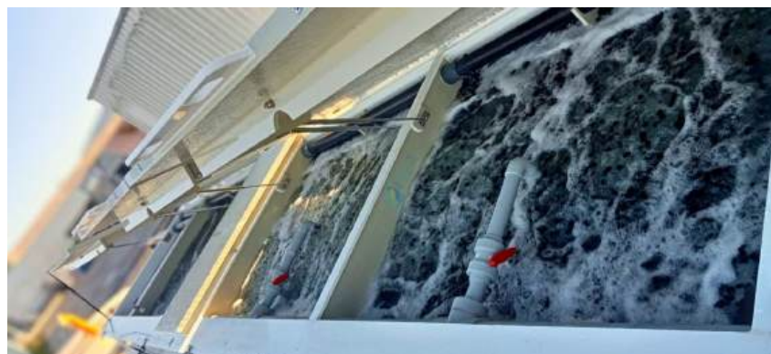
Dans cette filière biologique MBBR multi-étagée de 1h20 à 3, les différents compartiments assurent successivement la pré-dénitrification, le traitement du carbone et la nitrification, avant recirculation puis décantation.
