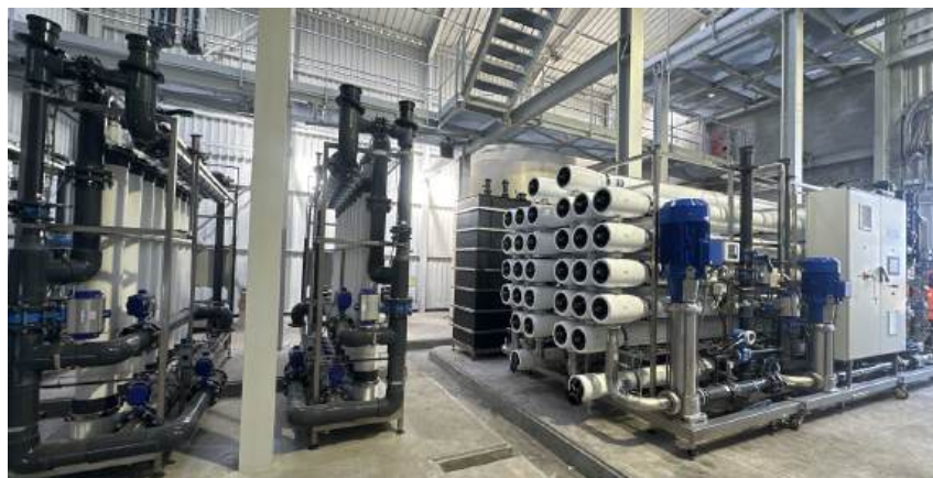
Pour le site Saipol (groupe Avril) de Sète, qui voulait remplacer l'eau potable par de l'eau recyclée, Chemdoc Water Technologies a déployé une unité R-Oasys qui traite les eaux usées traitées en sortie de STEP.
