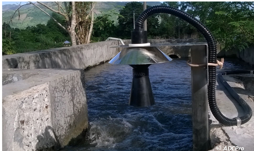
Le choix d'une solution dépend d'abord de la largeur, du marnage, de la profondeur d'eau, ou encore de la morphologie du terrain, chaque technologie (ici, un capteur de niveau à ultrasons Mach U) ayant ses avantages et ses limites.
