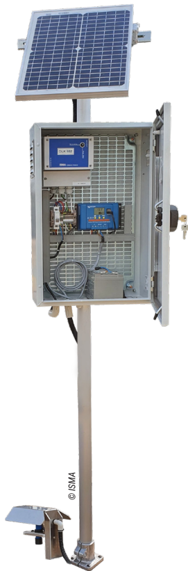
Les collectivités recherchent des systèmes autonomes et communicants (ici, un débitmètre DLK302 avec kit solaire d'ISMA), capables de fonctionner dans des zones parfois très isolées avec un minimum de maintenance.
