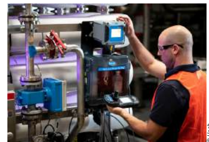
Les analyseurs de chlore (ici, un modèle colorimétrique CL17sc Ultra Low Range de Hach) font partie des instruments déployés pour la surveillance et le pilotage des moyens de traitement.
