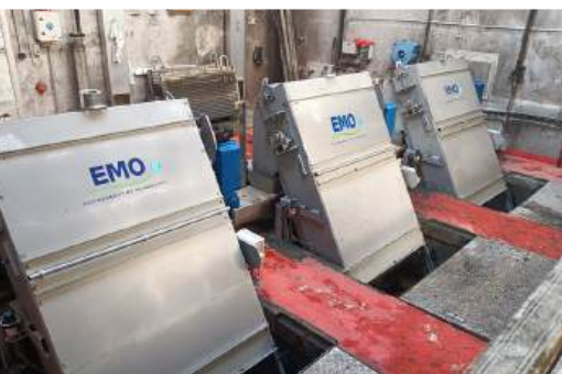
PRÉTRAITEMENT dégrilleur incliné à chaînes tendues
