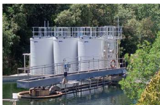
Traitement tertiaire par FILTRE À SABLE avant rejet en milieu naturel et/ou REUT
