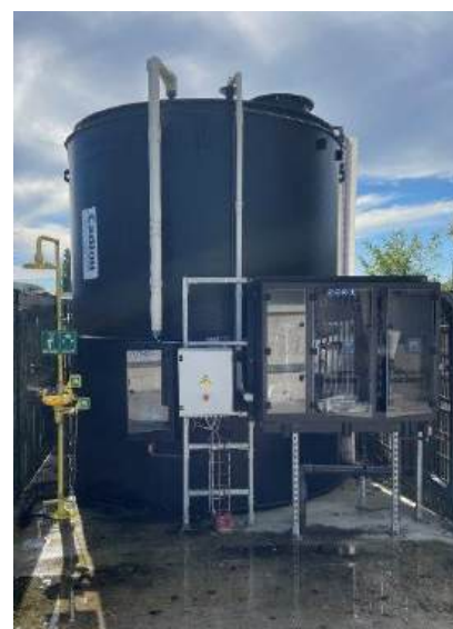
Il s'agit, ici, d'une installation de dosage de chlorure ferreux sur un poste de relevage en réseau d'assainissement.
