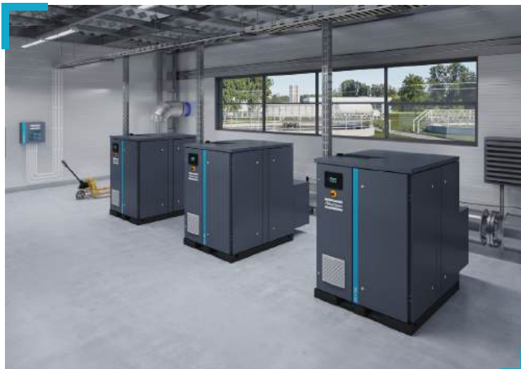
Surpresseurs à vis ZS4 VSD pilotés par un gestionnaire de centrale Basse Pression Optimizer 4.0 LP
