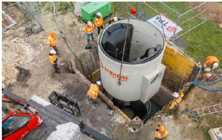
En installant récemment deux décanteurs hydrodynamiques DDSelect de Stradal à Marly, Valenciennes Métropole est en mesure de traiter jusqu'à 750 l/s et, donc, d'améliorer la qualité des rejets d'eaux pluviales dans le milieu naturel.
