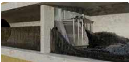
Fonctionnement de la vanne hydrodynamique autonome
