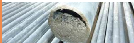
DIFFUSEURS BOUCHÉS EN FIN DE RAMPES DE DIFFUSION = BRAS MORT
