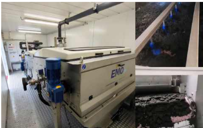
Il s'agit, ici, d'une étape d'épaississement en continu des boues sur table d'égouttage d'EMO, en amont d'un processus de méthanisation.
