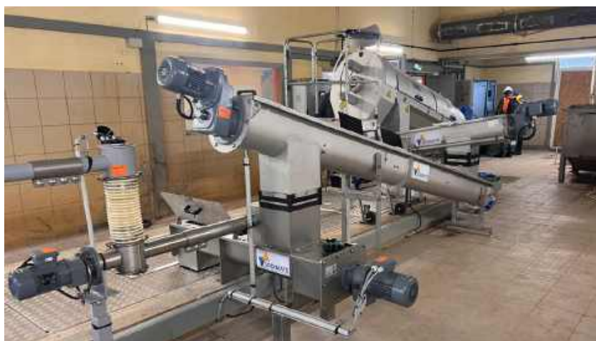
Sodimate a mis en œuvre, dans cette application, un ensemble constitué d'un système de convoyage de boues et d'un malaxeur.
