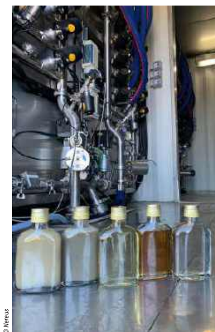
On voit ici l'effluent avant et après devant l'unité de filtration membranaire déployée par Nereus dans une installation de recyclage des eaux de distillerie en Martinique.
