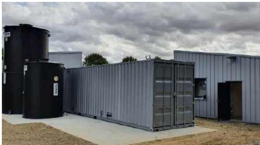
Veolia a réalisé une installation de REUT sur un site du pâtissier Pasquier. Les effluents de la STEP, après traitement, sont dirigés vers la TAR, qui était auparavant alimentée par de l'eau du réseau osmosée.
