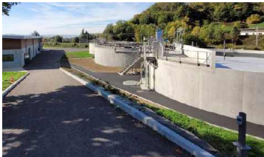
La station d'épuration réalisée par KWI pour un industriel du textile est constituée d'un local technique de 600 m 2 , d'un bassin tampon de 1 300 m 3 , d'un bassin biologique de 1 300 m 3 et d'une citerne d'eau réutilisée de 1 000 m 3 .
