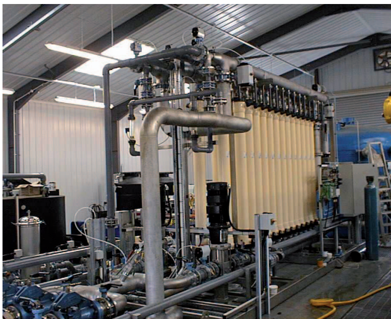
Usine de Peterborough, Royaume Uni, - 47 m 3 /h - Recyclage d'effluent secondaire à des fins d'arrosage de golf
