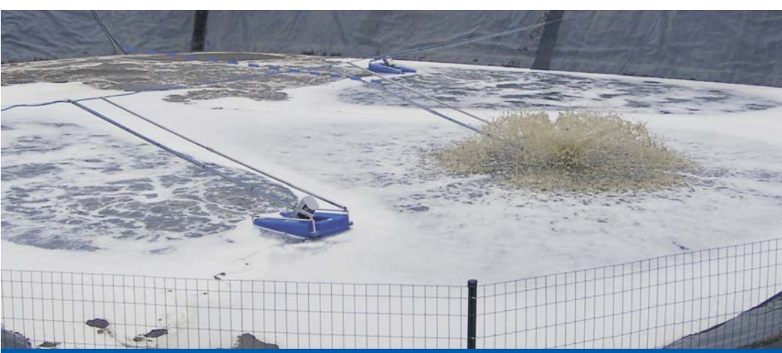
Flopulse et Hydropulse couplés en fonctionnement de jus compost
