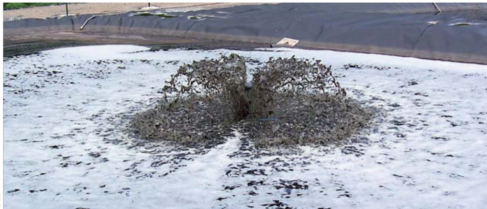
Flopulse 1,5 Kw en lagunage de lixiviat
