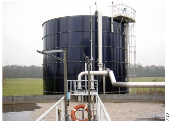
Cette technologie s'applique aux nouvelles installations de traitement biologique mais peut facilement s'intégrer sur des installations existantes.
