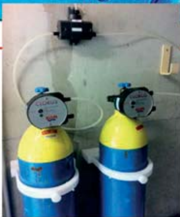
CHLORATION GAZEUSE DES EAUX POTABLES DES PISCINES MUNICIPALES DES EAUX INDUSTRIELLES
